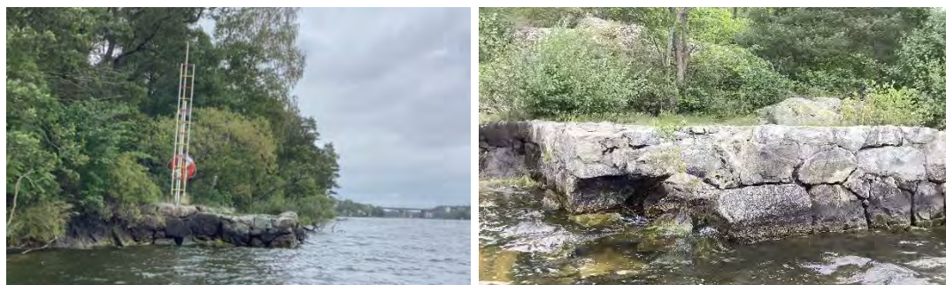
Figur 56. Äldre kaj/brygga med stenkista i dåligt skick som skapar konnektivetsproblem längst strandlinjen.
