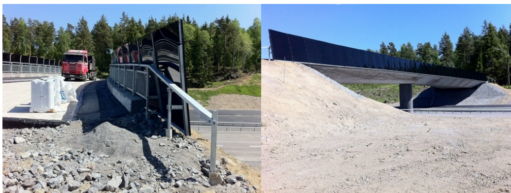
Figur 22. Exempel på avskärmning av faunabro i svart glas under konstruktion, från faunabro över väg 73 söder om Stockholm. Vy från bron (till vänster) och från väg 73 (till höger). Det är oklart om denna typ av skärmar är effektiva för brons ändamål. Foto: Marie Jakobi (Calluna AB).
