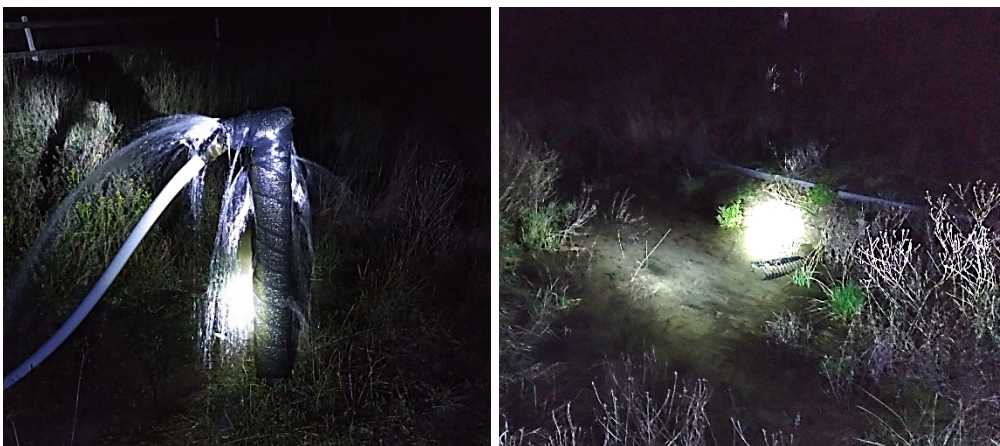
Figur 2. Till vänster syns den läckande anläggningen och till höger delar av vattensamlingen och röret som leder vattnet till delsträcka 4.
