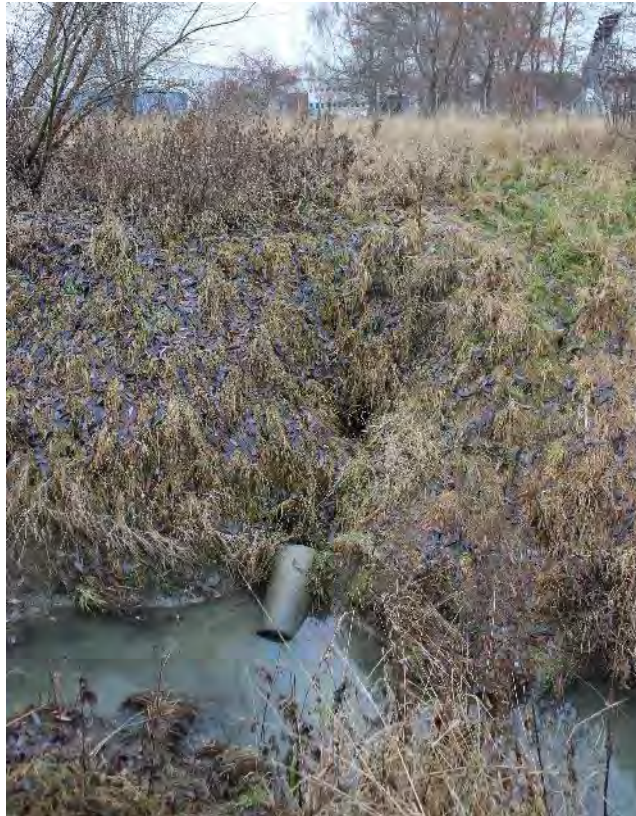
Figur 46. Dagvattenutlopp nedströms Svensbyvägen som behöver åtgärdas.
