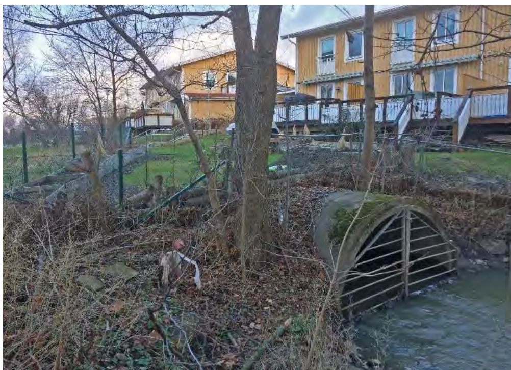
Figur 15. Gallret vid utloppet från kulverten vid Bromstensvägen utgör vandringshinder VH2:1
