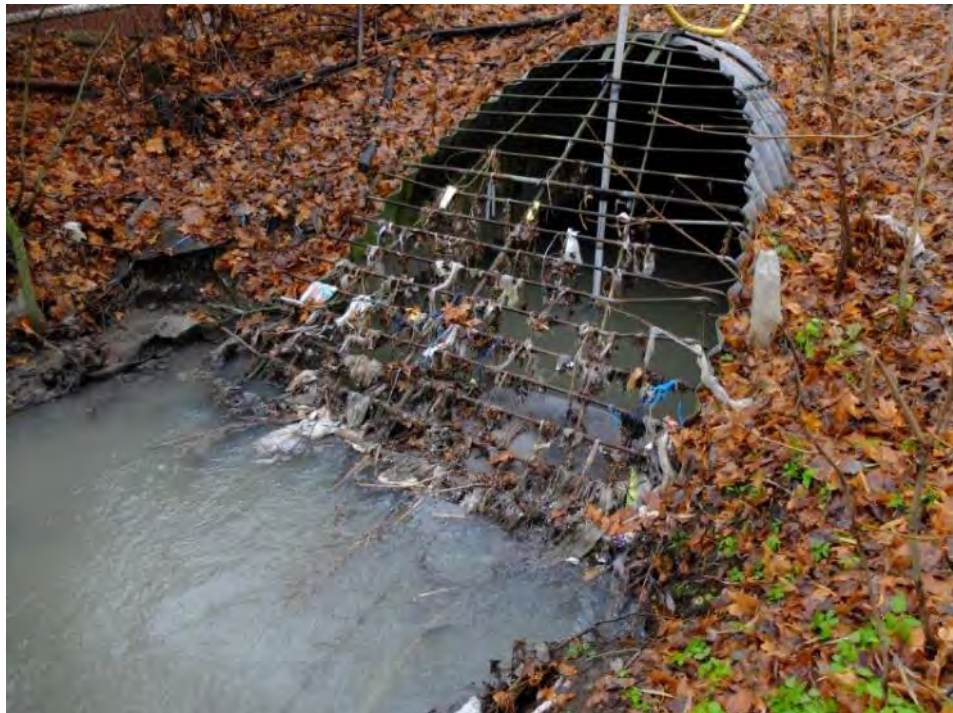
Figur 21. Vandringshinder VH 3:3 utgörs av ett galler där skräp kan fastna. Foto: Emåförbundet
