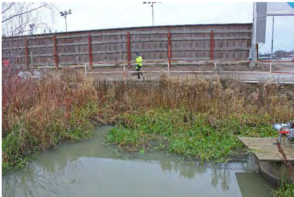
Figur 10. Utloppet från Solvalla är kraftigt igenväxt och stora mängder sediment har ansamlats vid trummorna
