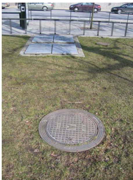
Figur 8: Avsättningsmagasinet vid Sankt Eriksplan. I förgrunden: brunnsluck ovanför själva magasinet (för mätning av slammängd samt tömning av slam). I bakgrunden: mansluckor för driftpersonalen.
