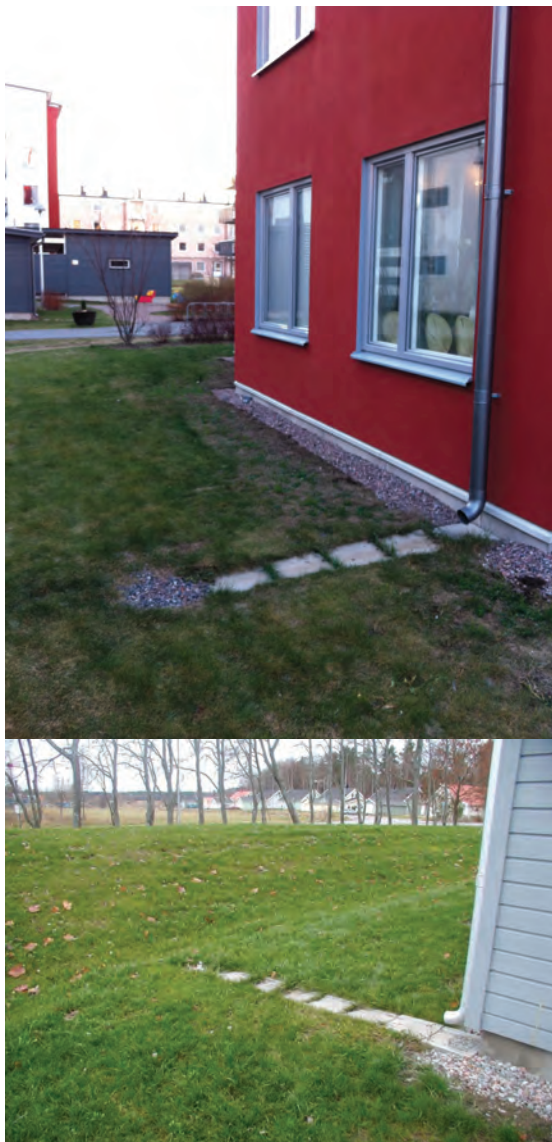
Utkastare och rännalsten/stensättning som avleder vattnet från byggnaden till gräsyta/svackdike.
