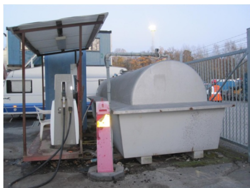
Bild 5. Tankningsställe hos Skanska Beläggning
