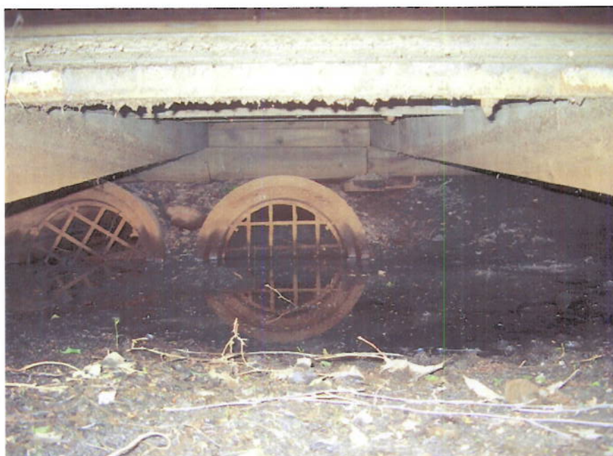
Figur 5 Vid skiborden som ska reglera vattennivån i Kyrksjön. Gallren är inlopp till dagvattenledningen som sträcker sig fram till Bällstavägen (första sträckan är 2 st 600-ledningar).
